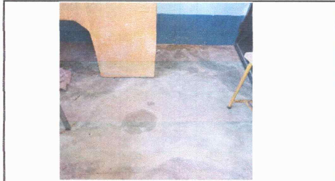
Foto 4: Se observa el deterioro del piso de la cocina
