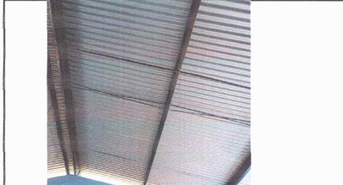
Foto 2: se observa que el techo tiene goteras
