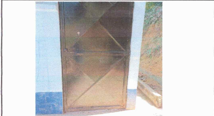
Foto 1: Se observa el deterioro de la parte baja de la puerta
