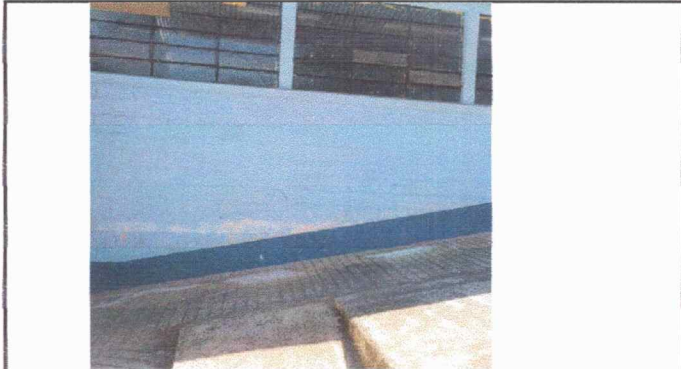
Foto 3: Se observa el deterioro de la pintura en los modulos
